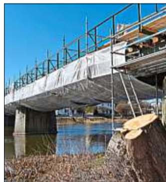
An der sanierten Naabbrücke müsste nachgebessert werden.
